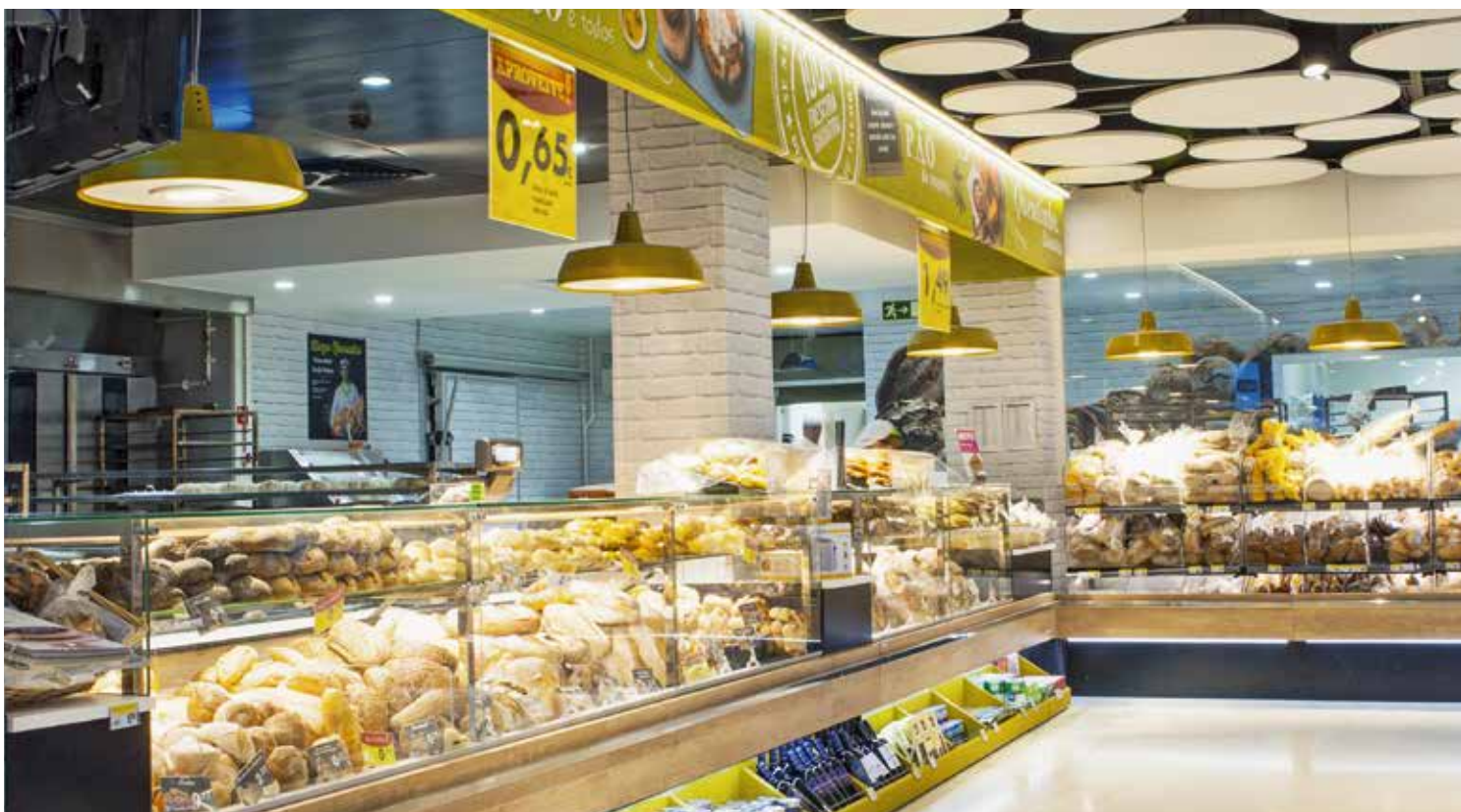
A secção da padaria conta com equipamentos da gama FUTURO da JORDÃO. The bakery section boasts equipment from JORDÃO's FUTURO range.
